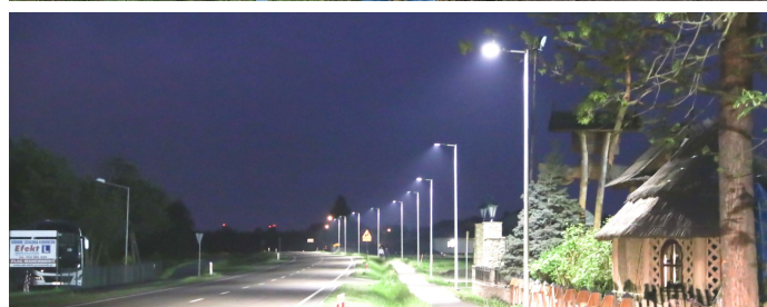
Oświetlenie uliczne - Białobrzeżki
