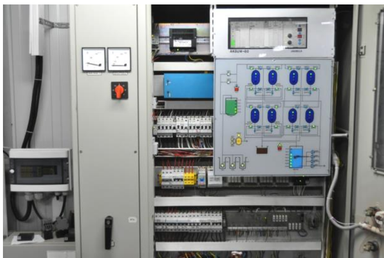
Szafa sterownicza na SUW w Jagielle
