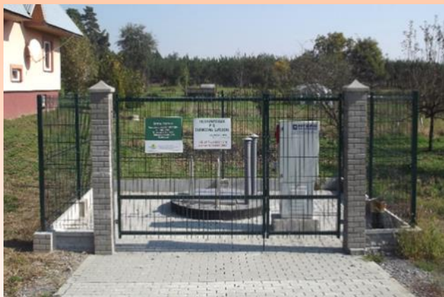
Przepompownia w Gniewczynie
