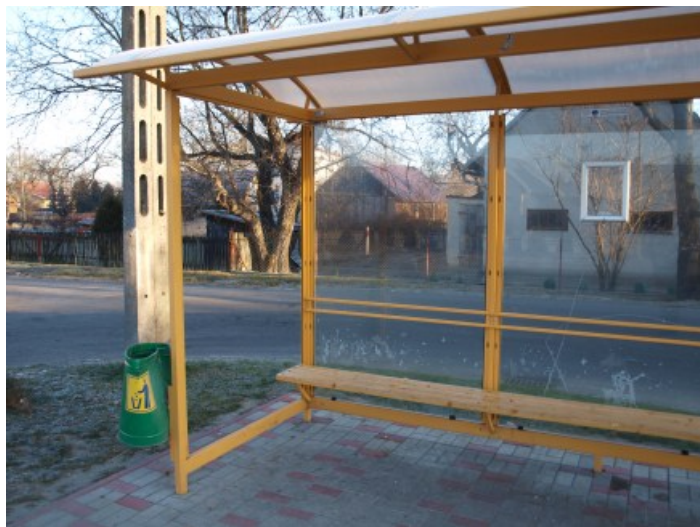
Wybita szyba i zniszczony kosz w nowej wiacie przystankowej
