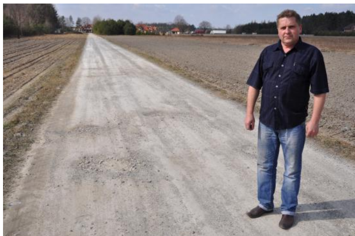
Ta droga wymaga remontu
