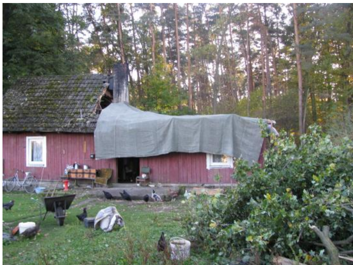
Tak wygląda zniszczony dom
