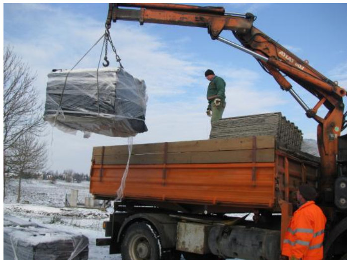
Wywóz niebezpiecznego odpadu
