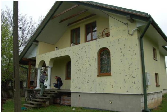
Zniszczona elewacja domu w Ubieszynie
