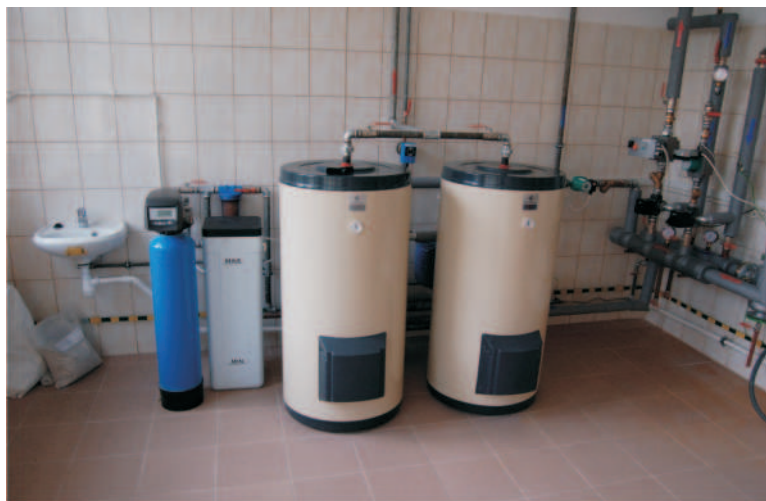
Nowoczesna kotłownia gazowa w szkole w Jagielle
