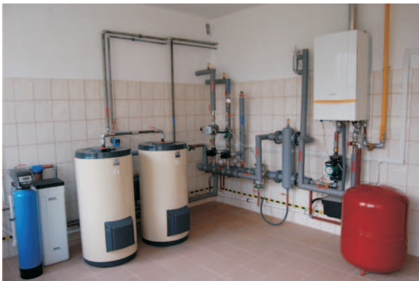
Nowoczesna kotłownia gazowa w Szkole w Jagiellie
